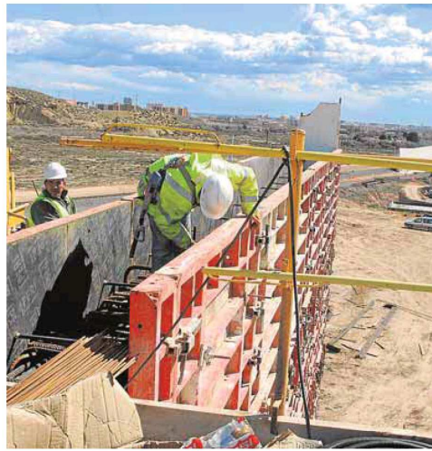
Dos trabajadores en un proyecto de obra civil en Alicante. :: D. M.
